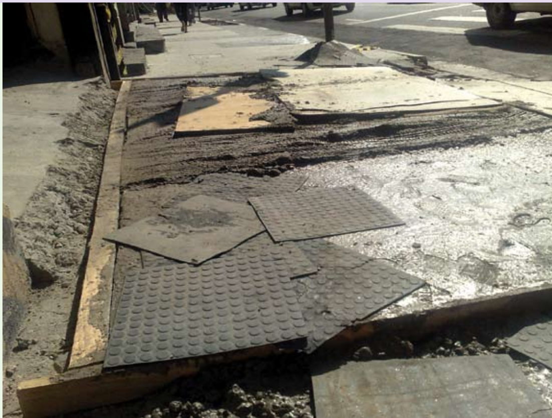
Descaso da administração pública com ruas e calçadas não permite o acesso à cidade
