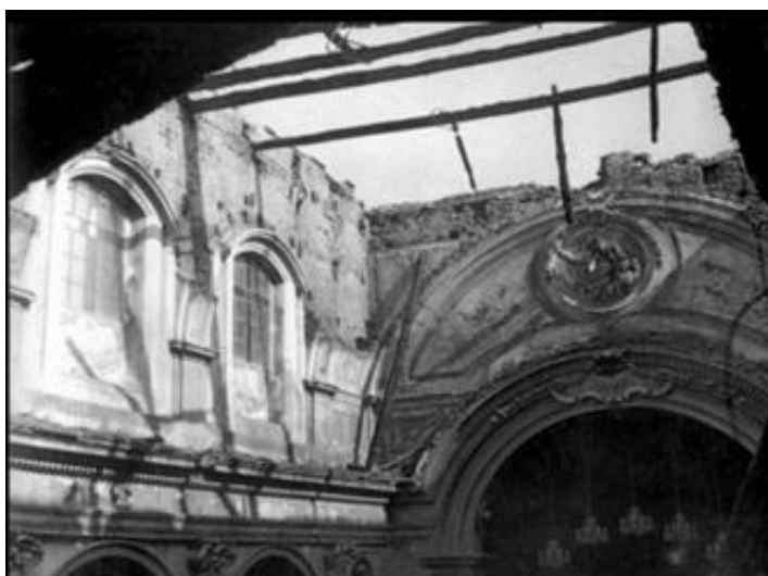
Fig. 17: Situação após o incêndio: desabamento do teto. Fonte: www.marcodezzibardeschi.com
