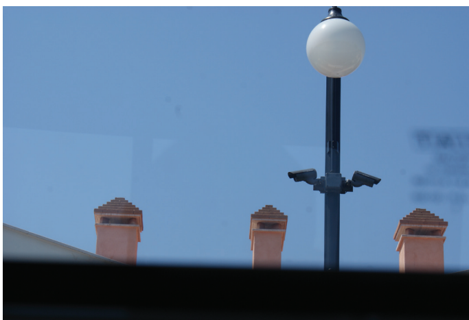
Telecamera posizionata sotto le fonti di illuminazione
