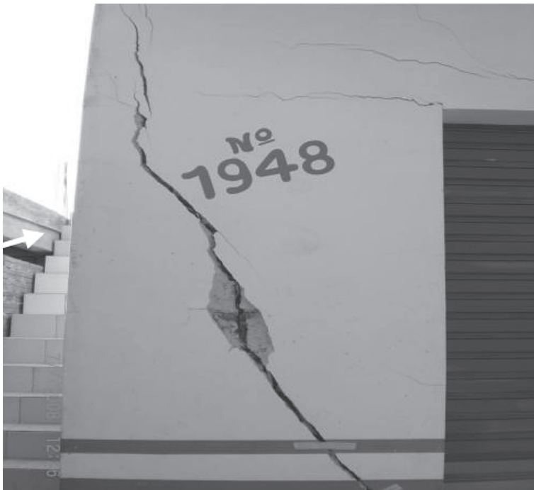
Figura 3 – Rachadura em edificações ocorrida por acomodação do solo em terreno cárstico
