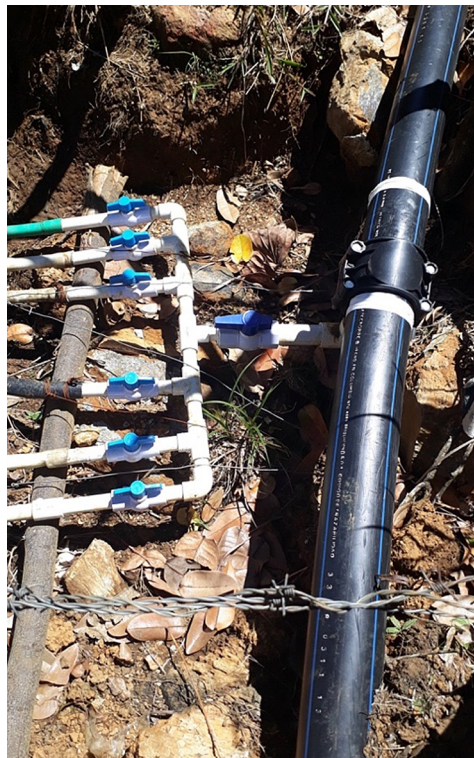
Figura 5 – Colar de tomada e distribuição de água para as moradias “irregulares” de Bello Oriente a partir da adutora comunitária
