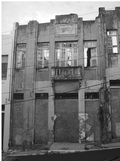
Figura 11 – Casarão 27 da Rua João Suassuna
