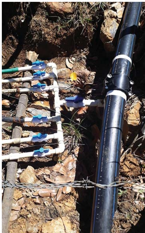
Figura 5 – Colar de tomada e distribuição de água para as moradias “irregulares” de Bello Oriente a partir da adutora comunitária
