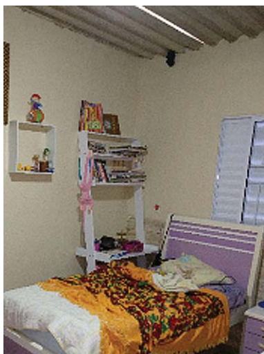
Figura 9 – Casa 18, o telhado de fibrocimento na ampliação da casa deixa fenda de luz visível
