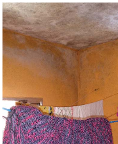
Figura 10 – Casa 18, mofo nas paredes e lajes persiste mesmo com a construção do segundo pavimento
