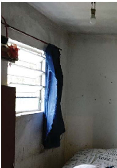
Figura 7 – Casa 22, caixilho muito menor que o necessário em dormitório
