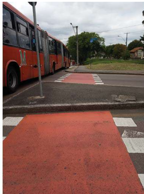
Imagem 1 Lack of curb ramp – Santo André street versus Pres. Alfonso Camargo avenue (Capão da Imbuia)
