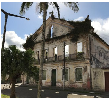
Figura 1: Situação atual da fachada do prédio. Foto: Wagner Magalhães – Julho de 2018
